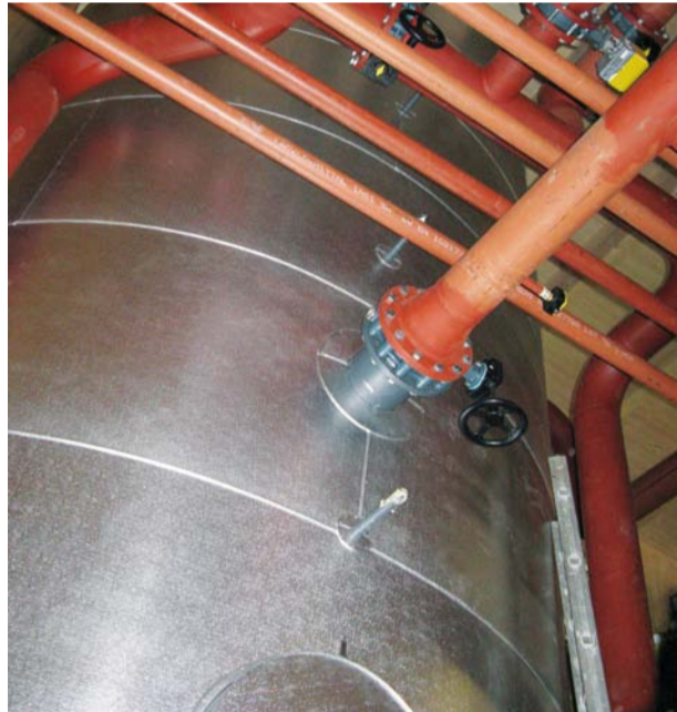
Der FEURON-Hochleistungsspeicher ist angeschlossen.
