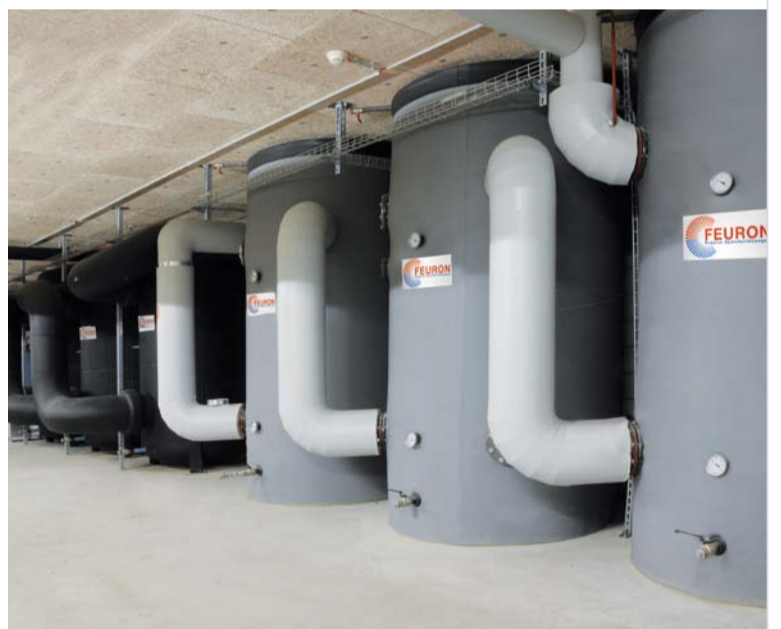
Die FEURON-Speicher im Herzen der arenaThun.
