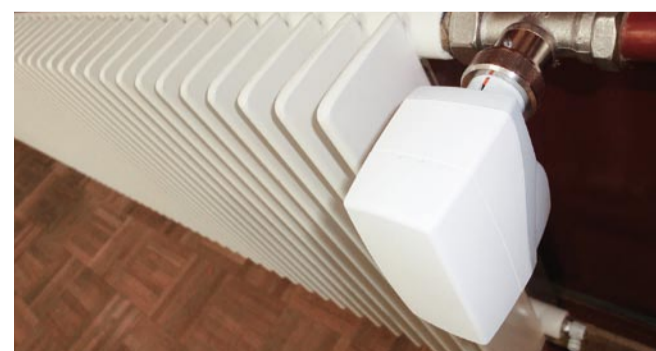
Die bisherigen Thermostatventile an den Radiatoren können durch die EnOcean-Funk-Stellmotoren ohne Verkabelung in die Einzelraumsteuerung integriert werden.
