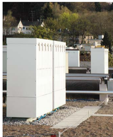
Die Technik auf dem Dach – die Dachzentralen.
