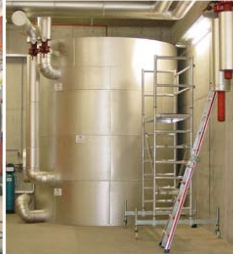
Speicher mit 25'000 Liter für Biomasseanlage.
