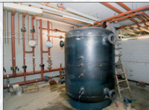
Fertiger Speicher – zum Anschluss bereit
